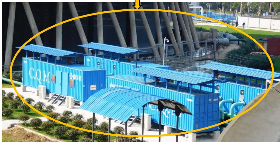
据付現場で撮影した写真です
