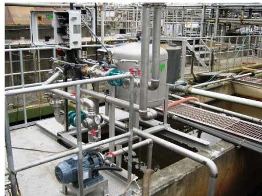
(排水処理工場で稼働の HMF2-30)
