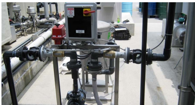
(密閉型タワーの冷水濾過処理)
